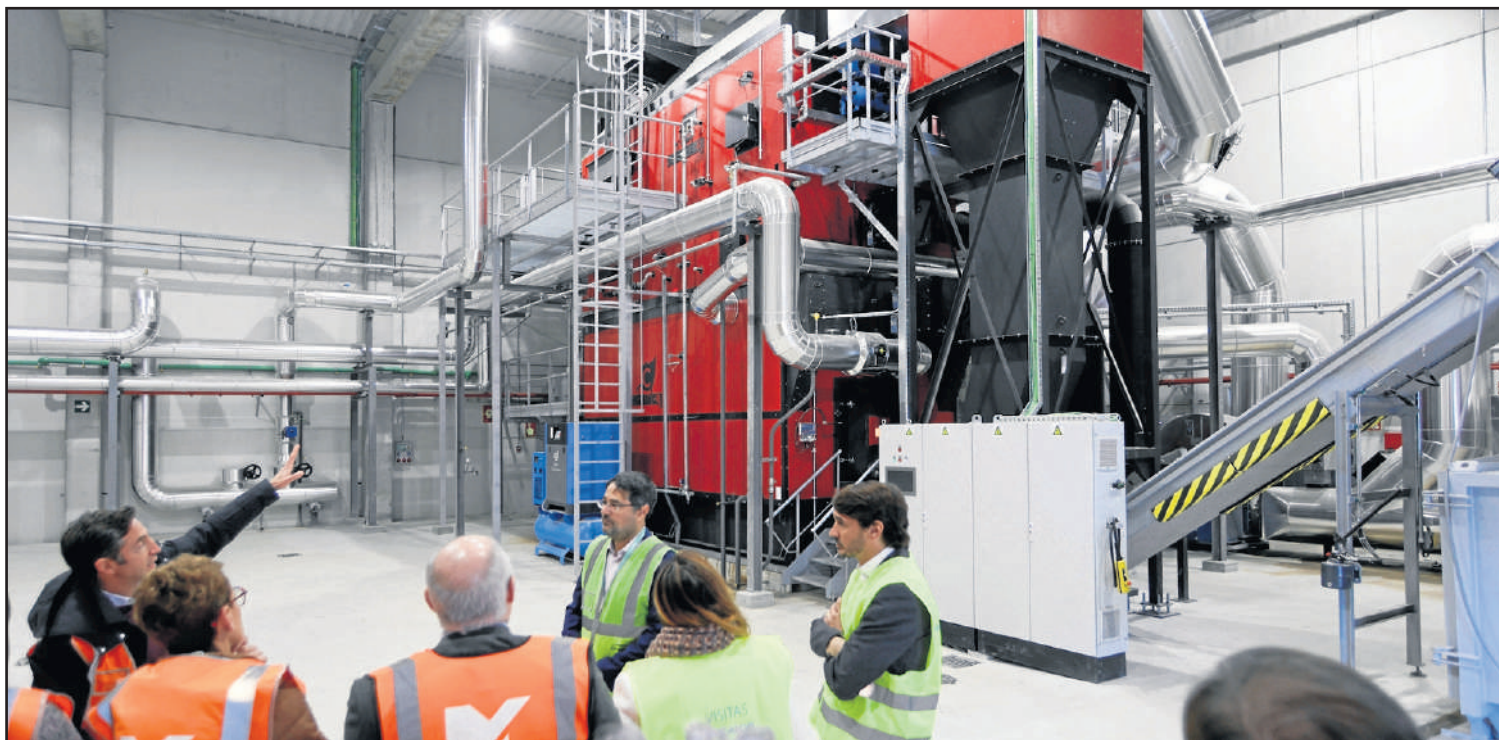
Visita institucional a la planta de generación de la red de calor. GOBIERNO DE NAFARROA
